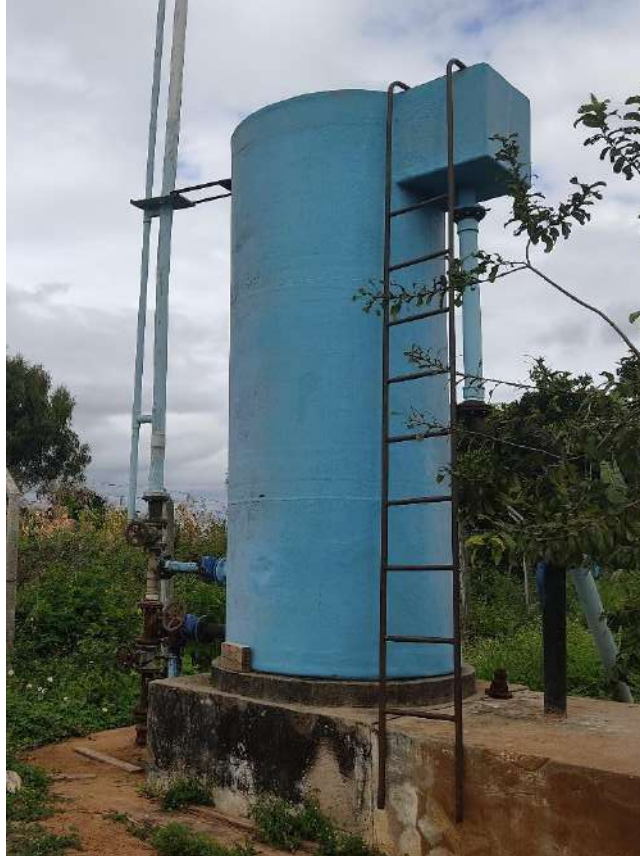
Figura 3.10 - Estação elevatória de água tratada do município de Serrinha dos Pintos
