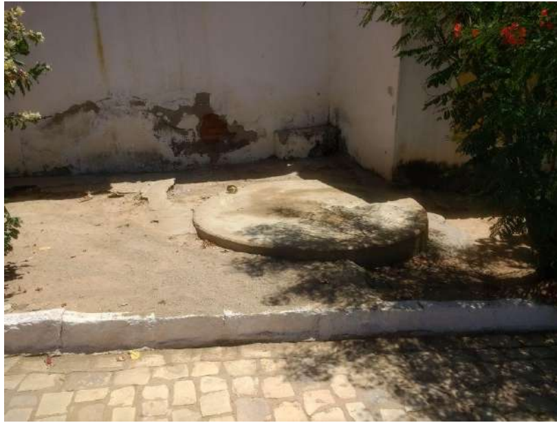
Figura 3.32 – Fossa rudimentar na zona urbana de Serrinha dos Pintos.
