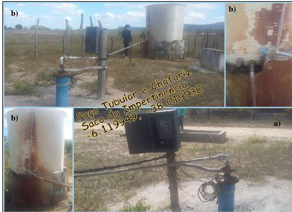
Figura 3.20 – a) Poço tubular; b) chafariz do Sítio Ponta da Serra.
