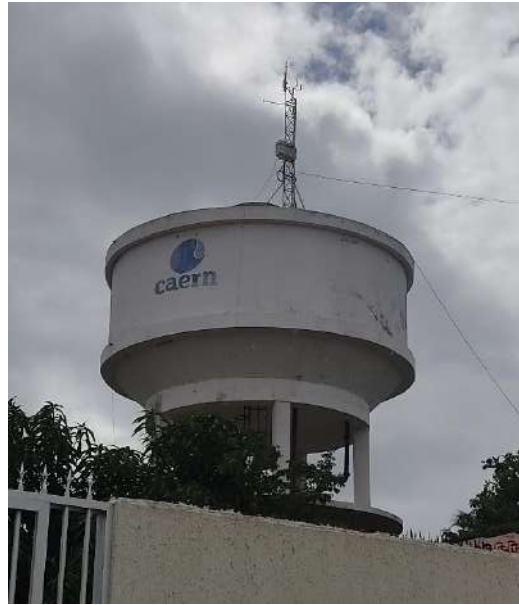
Figura 3.11 – Reservatório elevado da Sede do Município de Serrinha dos Pintos/RN.
