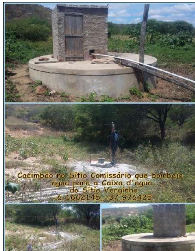
Figura 3.27 – Poço com casa de máquinas localizada no Sítio Varginha.
